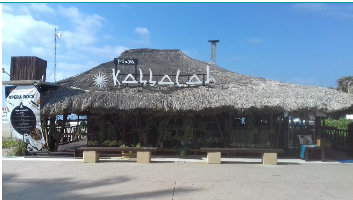
ILUSTRACIÓN III-13. NÓTESE LA CONDICIÓN PRECARIA DE LA PALMA DEL TECHADO DE LA PALAPA LA CUAL SERA REHABILITADA.
