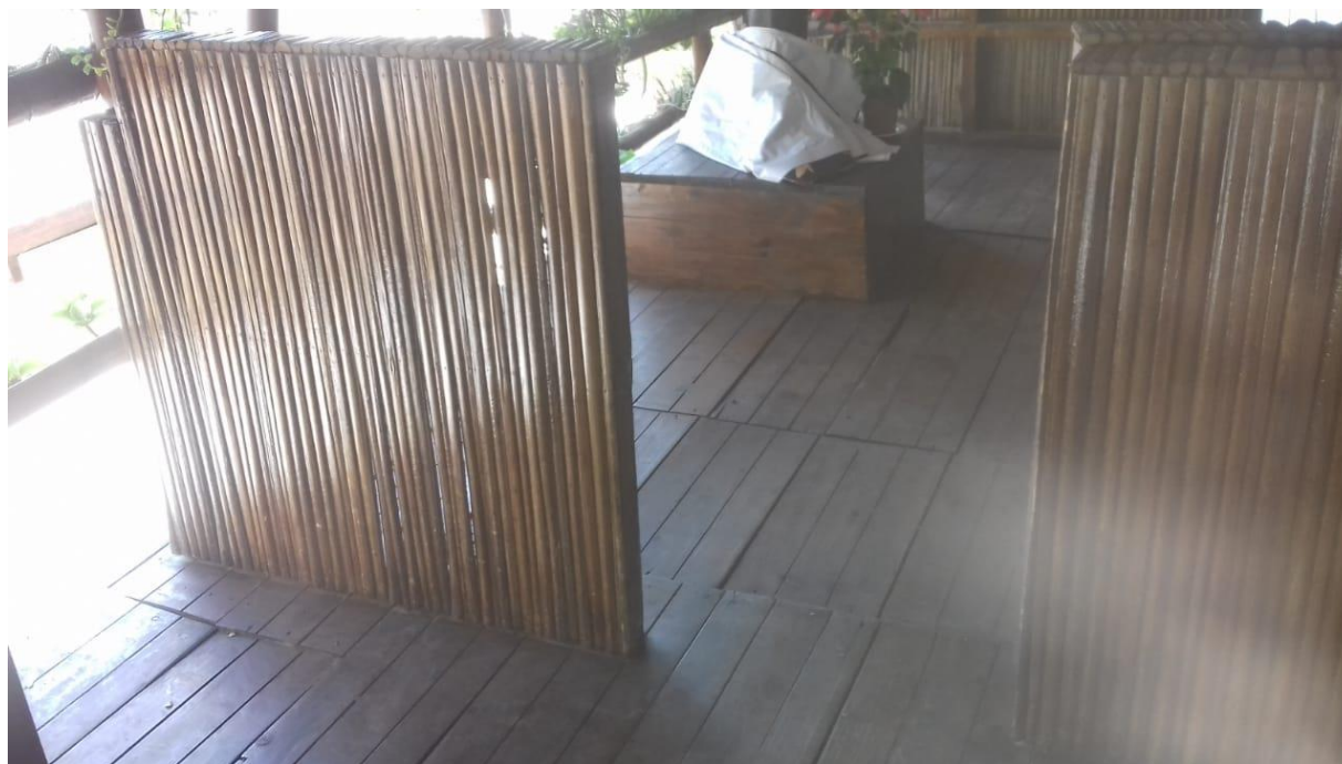
ILUSTRACIÓN III-12. DUELA DEL PISO LA CUAL SE ENCUENTRA DAÑADA Y QUE SE REHABILITARÁ
