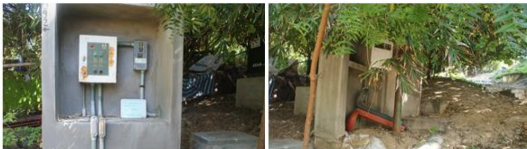
Ilustración II-89 Mampara de Controles.
