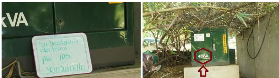
Ilustración II-90 Estación Subeléctrica de 45 Kilovoltiamperi (KVA).
