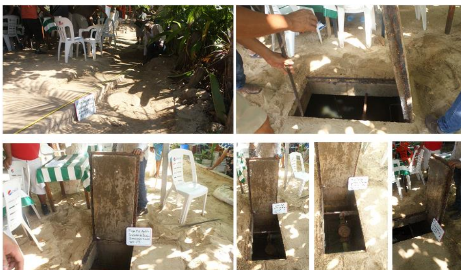
Ilustración II-44 Carcamo de Bombeo de Playa Pto. Angelito.
