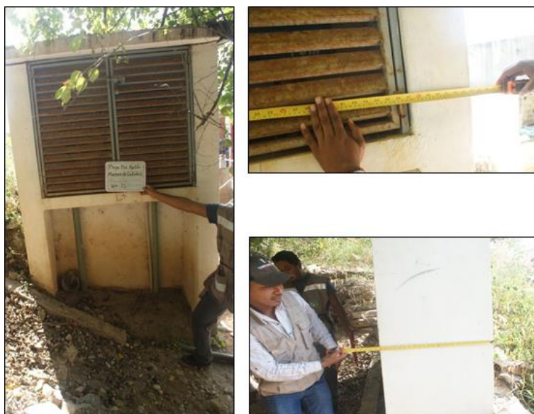
Ilustración II-45 Mampara de controles.
