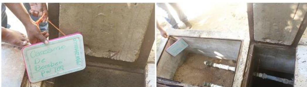
Ilustración II-88 Cárcamo de Bombeo ubicado en Playa Manzanillo.
