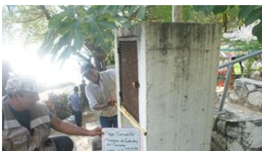
Ilustración II-102 Cárcamo de Bombeo Subterráneo.
