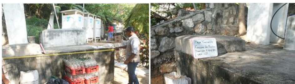
Ilustración II-101 Cárcamo de Bombeo Subterráneo.
