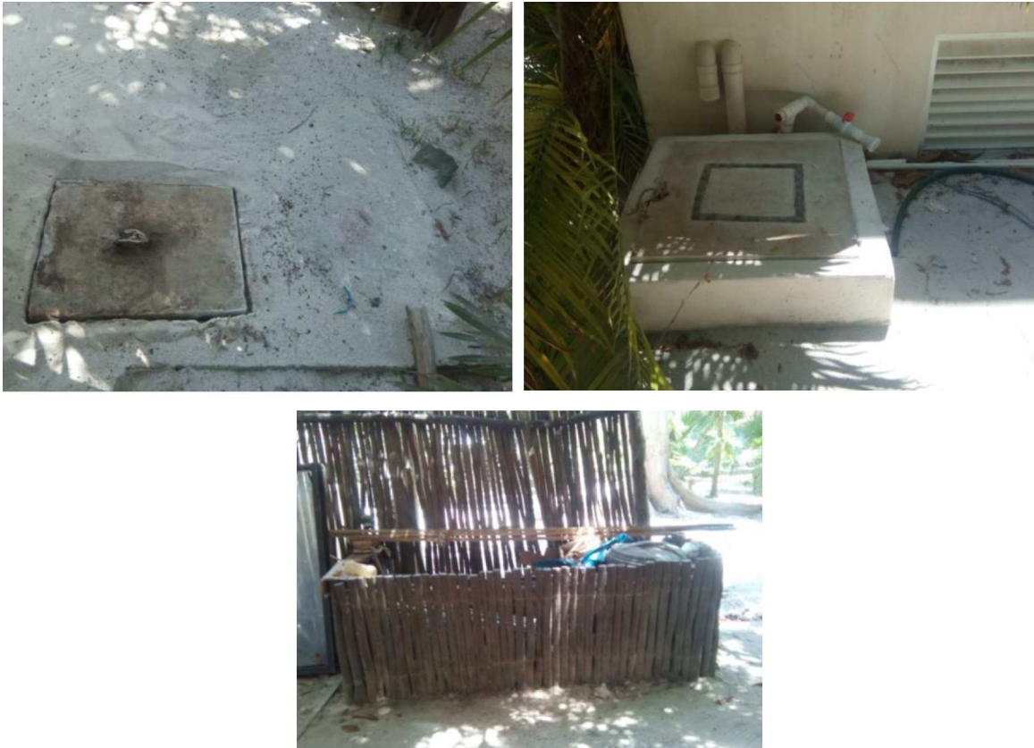
Figura 12. Registros 1 y 2, y contenedor de residuos sólidos.
