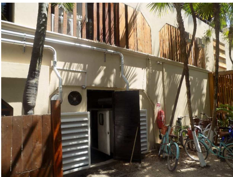
Figura VIII. 7 Cuarto de generadores de energía
