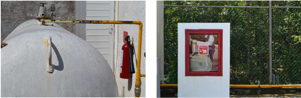
Figura II.12. Obra de resguardo de tanque de gas L.P.
