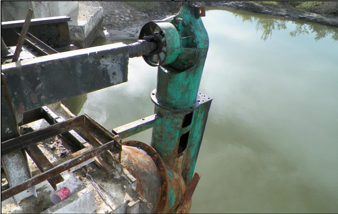
Cárcamo de bombeo.
