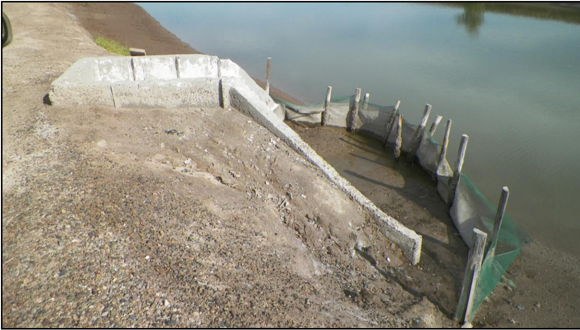
Compuerta de llenado con mallas filtradoras.
