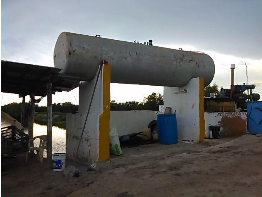
Tanque elevado para suministro de Diesel marino, para el abastecimiento de los equipos de bombeo.
