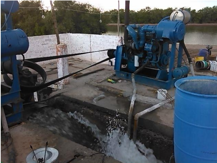
Cárcamo de Bombeo.
