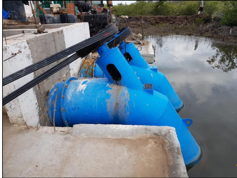
Fotografía 2. Cárcamo de bombeo.
