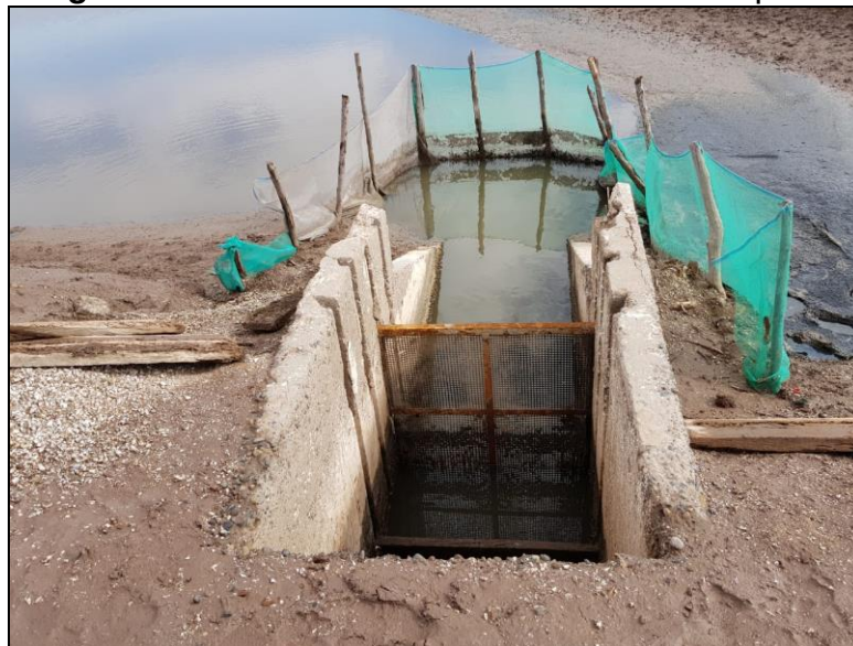
Fotografía 3. Estructuras de alimentación o compuertas.
