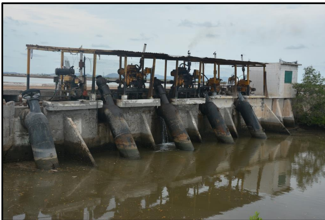
Figura II.4 Estación de bombeo de la granja ACUASHIRMP SPR. DE RI.
