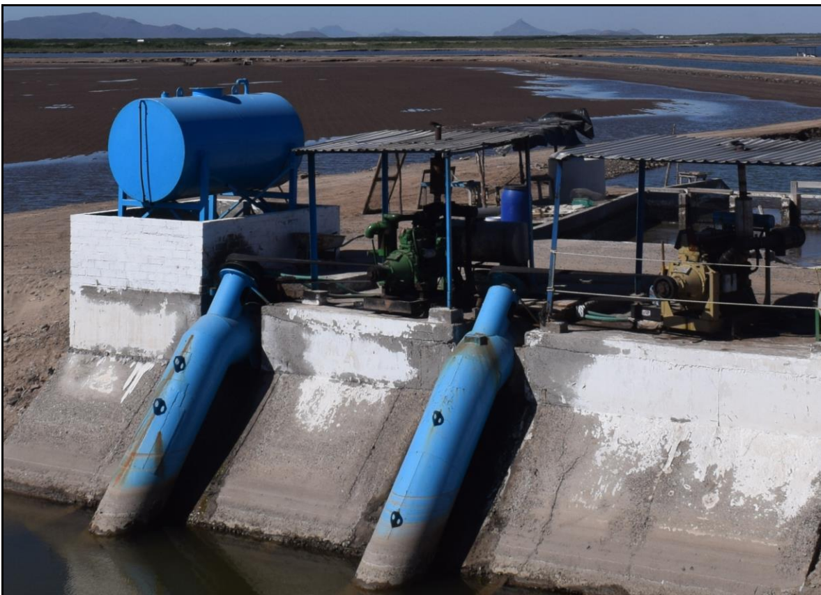
Tanque de combustible 6,000 litros de capacidad y cárcamo de bombeo.
