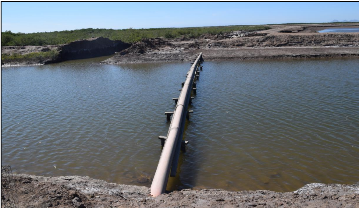
Tubo de drenaje descarga del estanque No. 10 a dren perimetral.
