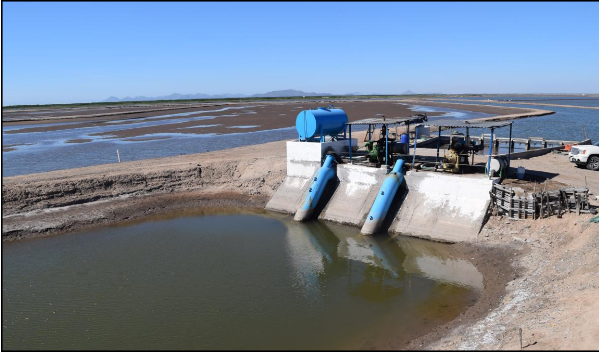
Vista panorámica del cárcamo de bombeo e infraestructura asociada.
