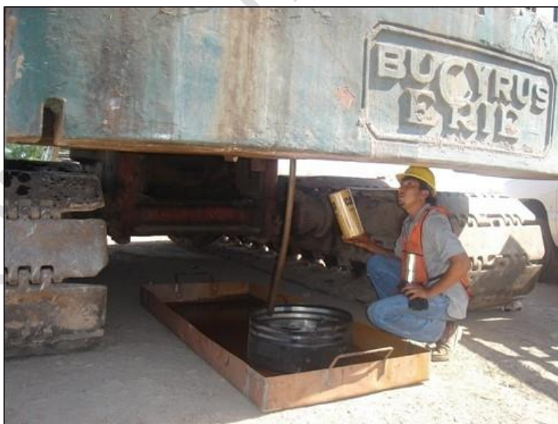
Fotografía No. 4.- Ejemplo de la instalación de charolas que atrapan aceites.
