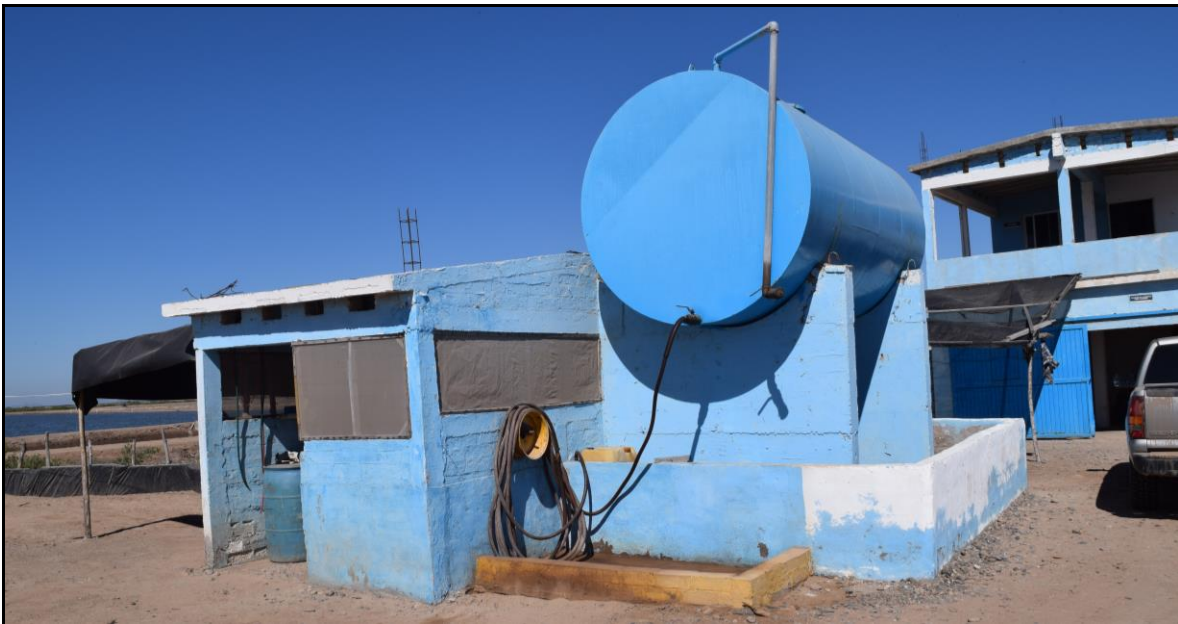
Área del tanque de combustible diésel que tiene un contenedor para prevención de fugas/derrames de combustible, a un lado esta el almacén de residuos peligrosos.
