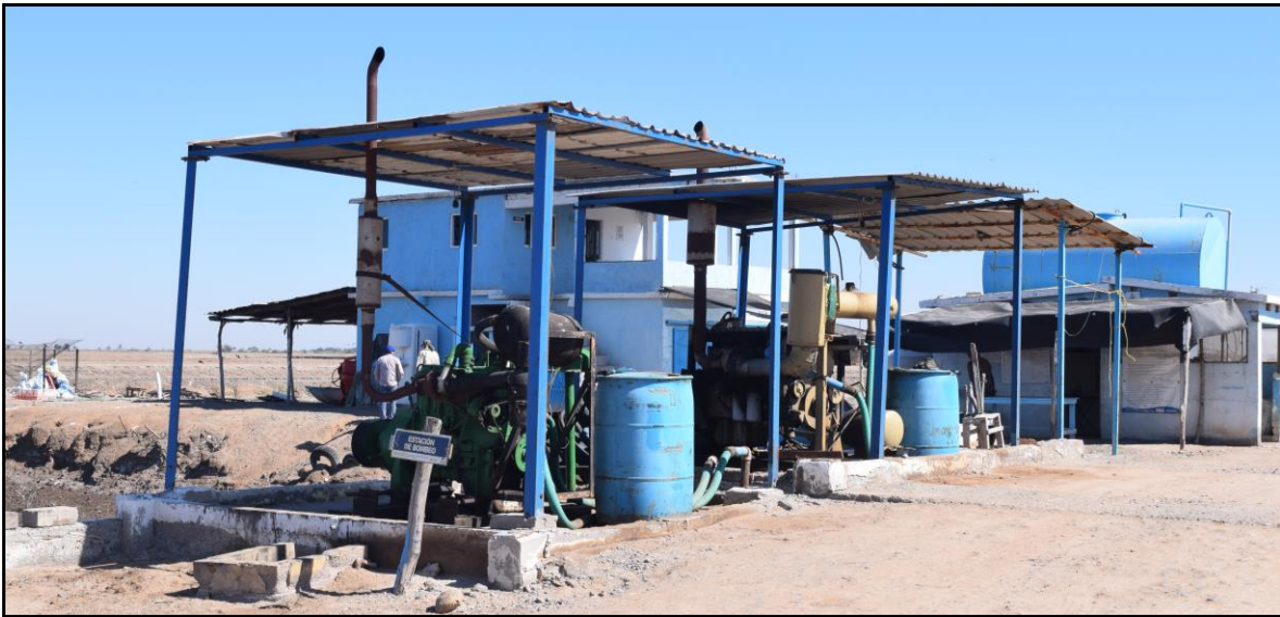
Estación de bombeo.
