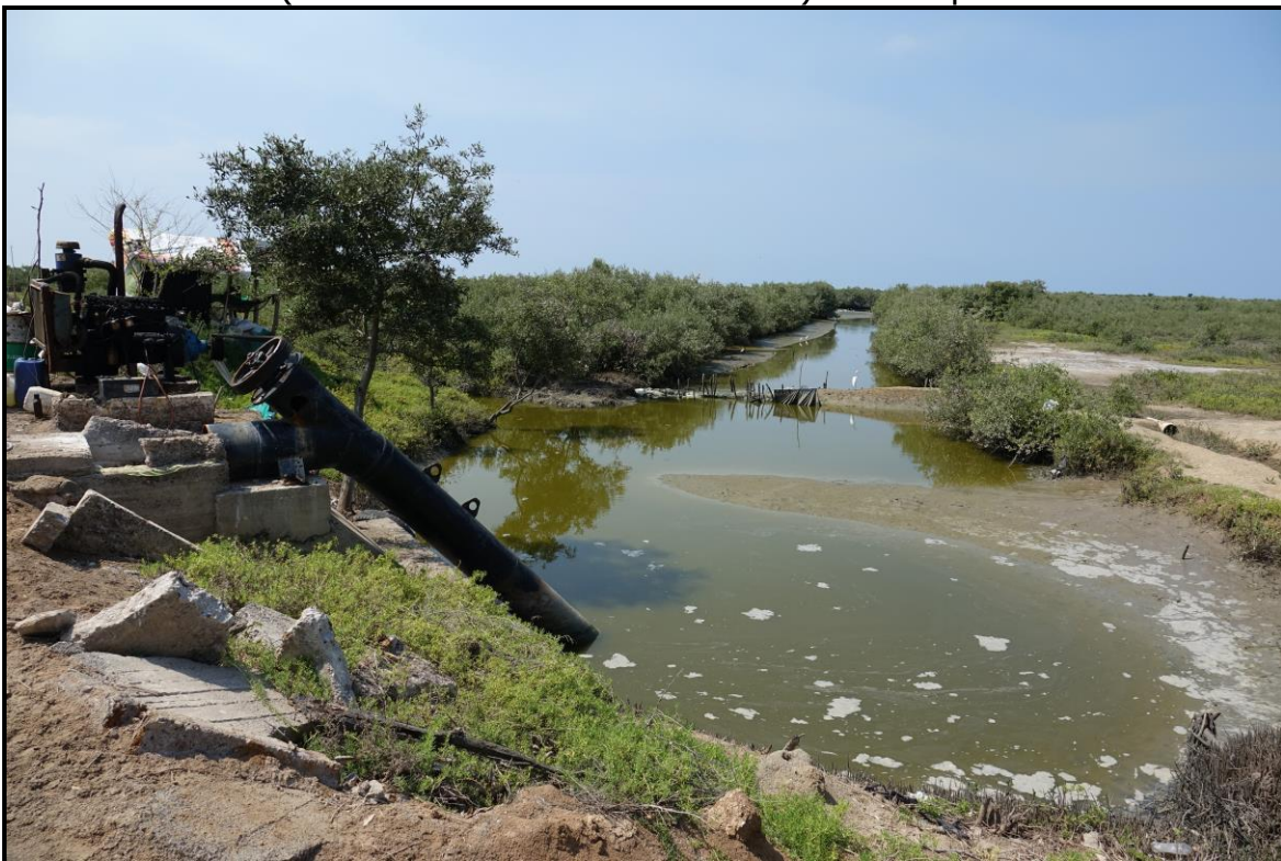
Brazo de estero existente que funciona como canal de llamada. Esta es la única bomba con la que cuenta la granja y solo bombea para mantener el nivel del tirante de agua en el estanque No.1.
