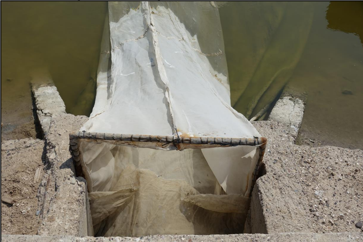
Malla filtradora en compuerta de entrada estanque #1.
