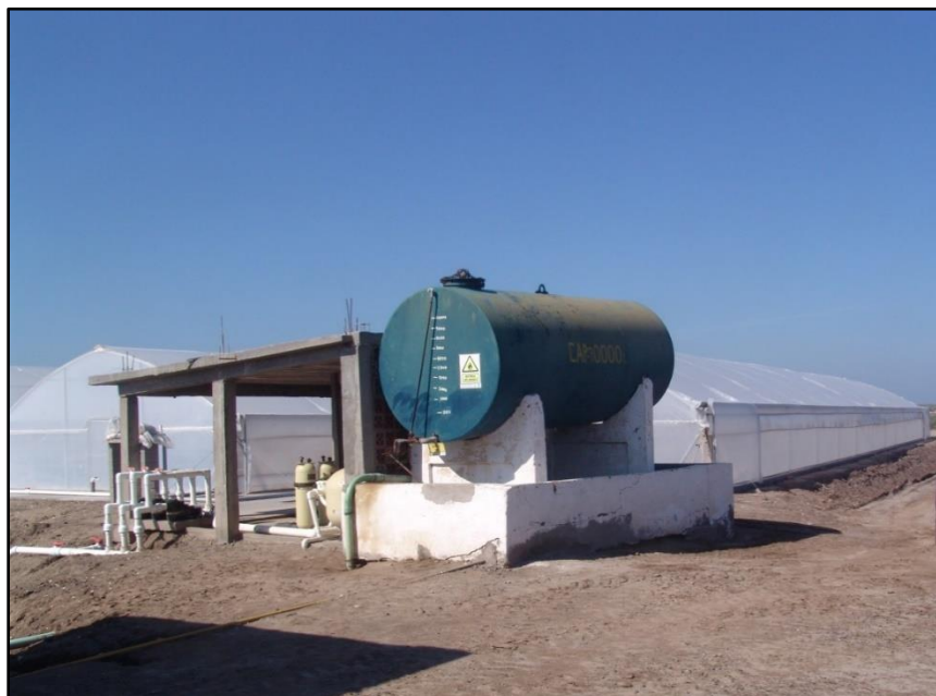
Figura II.5.- Tanque de diésel instalado
