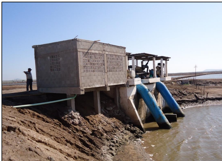
Figura II.4.- Imagen del cárcamo de bombeo de Acuícola Pleamar S.A. de C.V.
