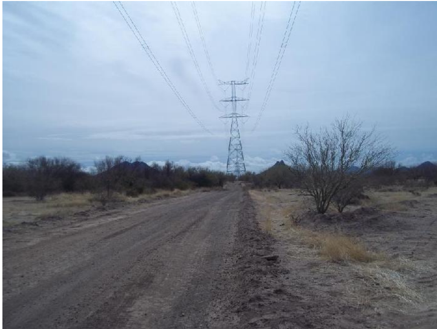
Línea de transmisión eléctrica de CFE, en el predio.
