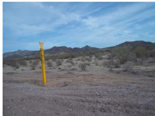
Gasoducto de Gas Natural
