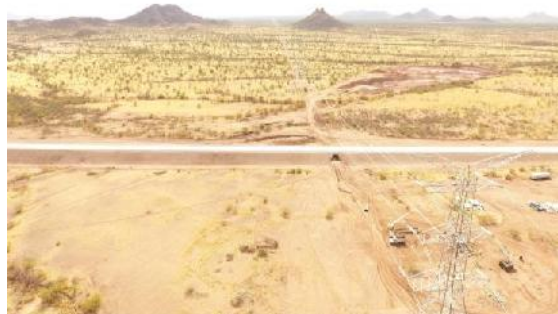
Libramiento Hermosillo, torres y línea de transmisión eléctrica
