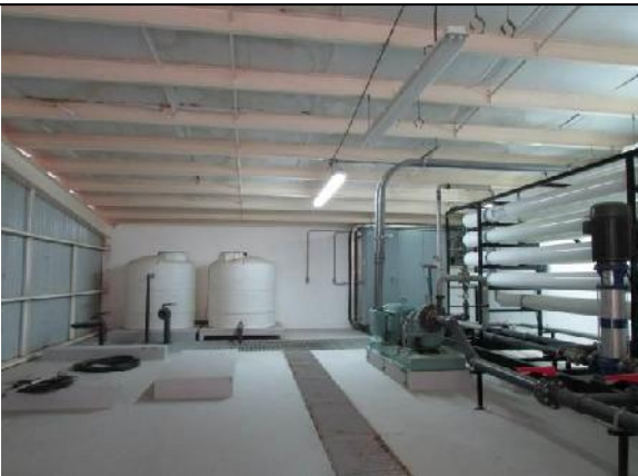
Fotografía II. 23 Planta de ósmosis inversa
