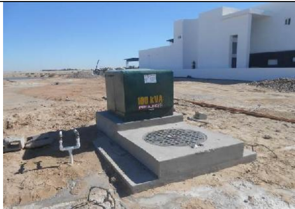
Fotografía II. 9 Transformador de energía
