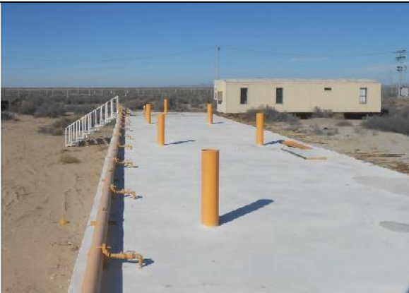
Fotografía II. 11 Planta de tratamiento de aguas residuales
