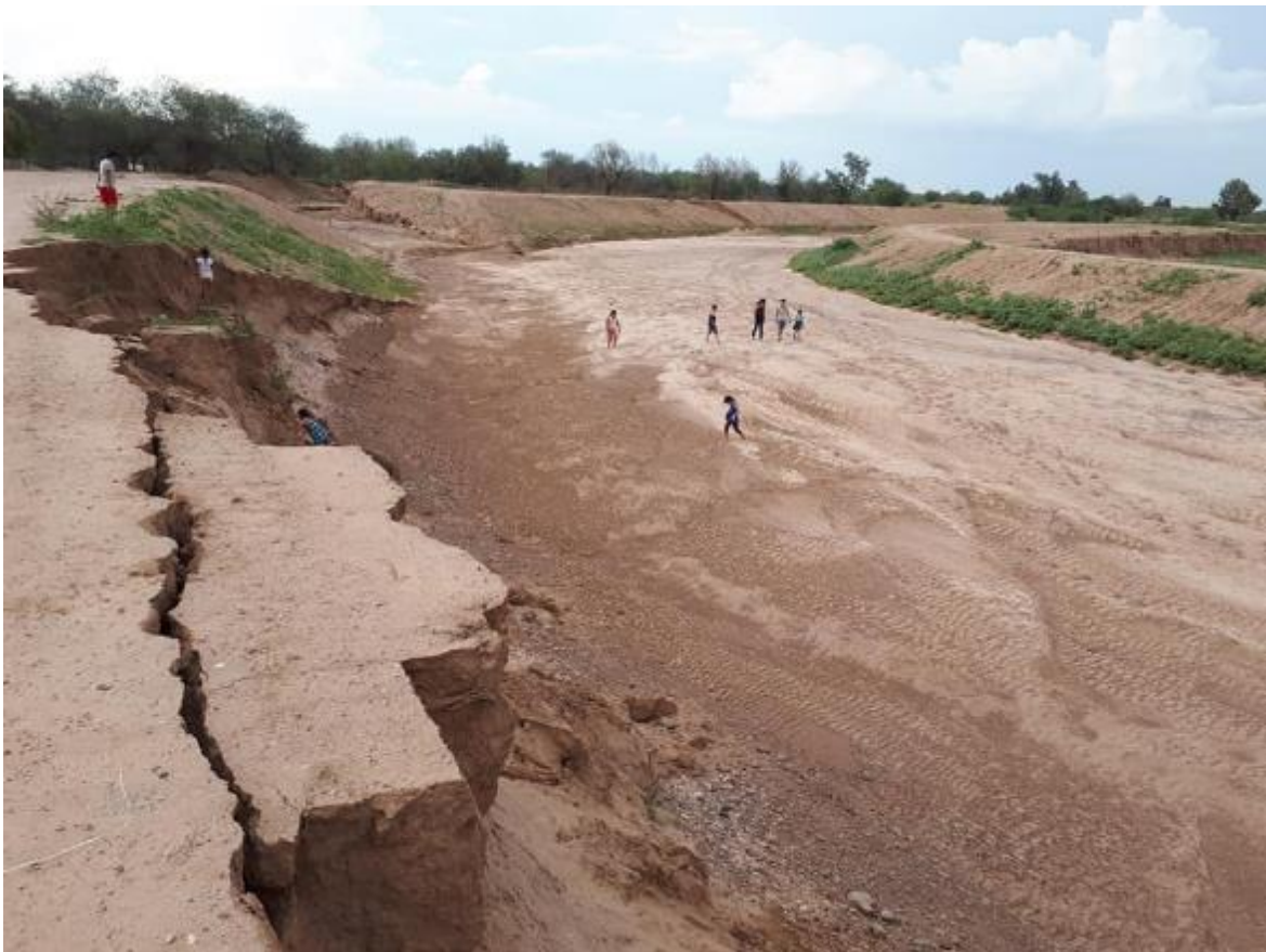
Figura II.10.- Rompimiento de bordo en La Victoria. Agosto 2018
