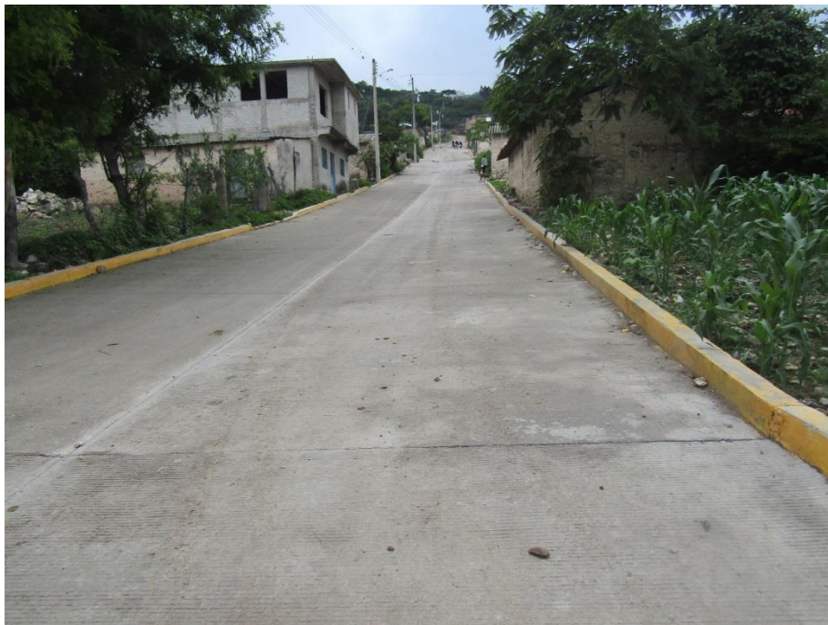
Figura 65. Servicios públicos básicos de La Esperanza (Calle pavimentada).
