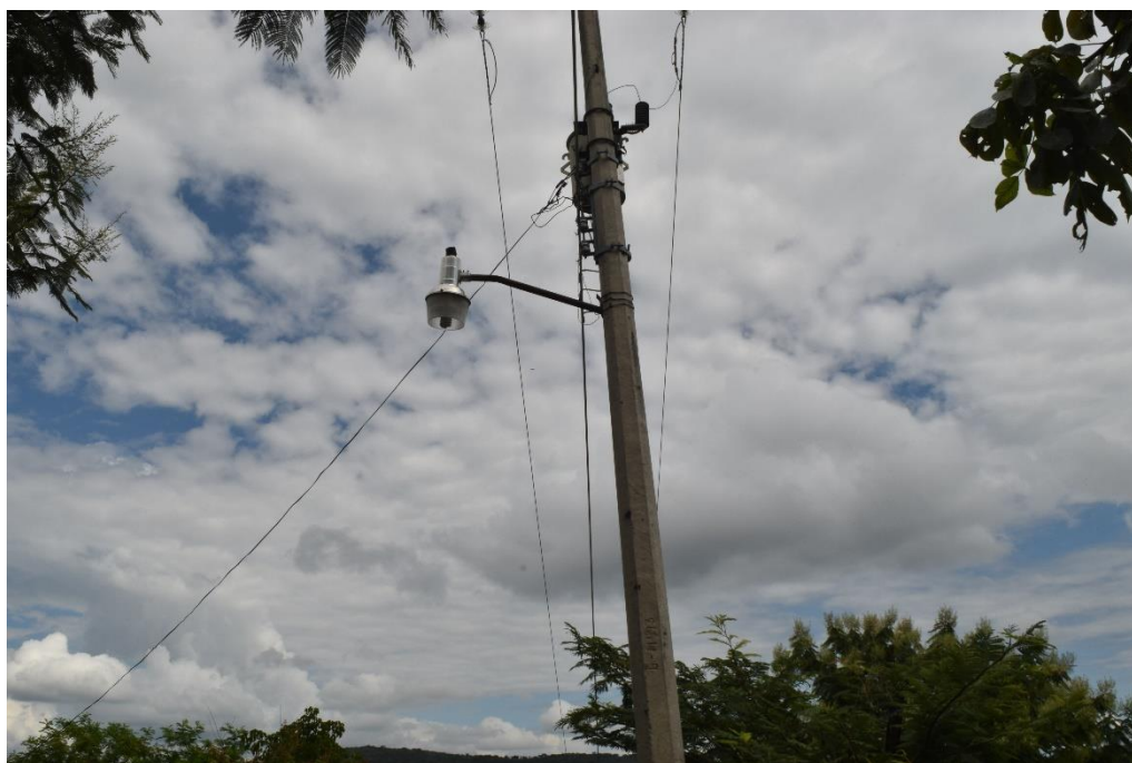
Fotografía 10.- Servicio de electrificación existente en el ejido.
