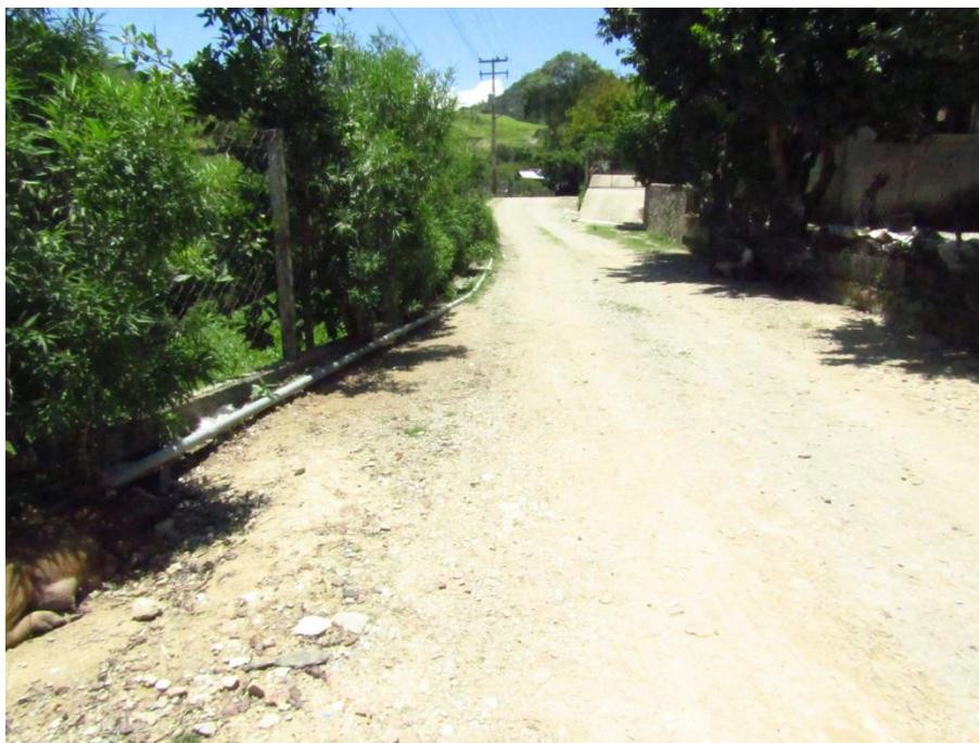
Figura 65. Servicios públicos básicos de Tolixtlahuaca (tubos galvanizados para el agua potable).
