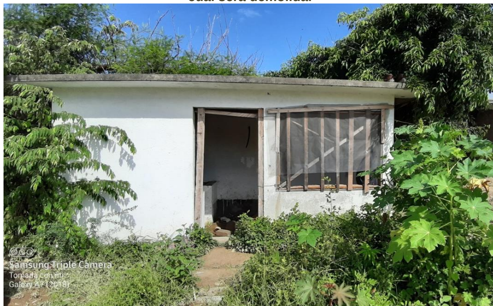
Fotografía 6.- Estructura identificada dentro de uno de los clústeres, y se observa deteriorada, la cual será demolida.
