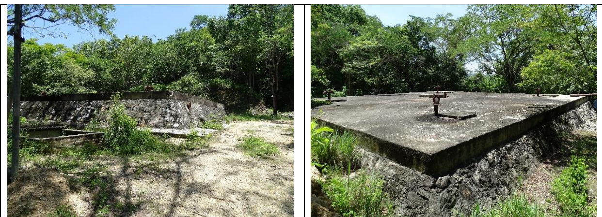
Fotografías del tanque de almacenamiento.
