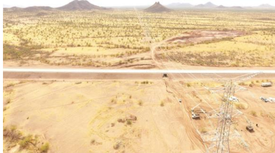
Libramiento Hermosillo, torres y línea de transmisión eléctrica
