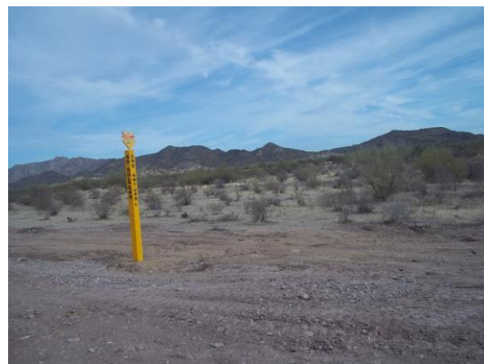
Gasoducto de Gas Natural
