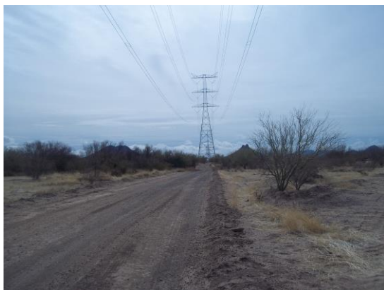
Torres de línea de transmisión eléctrica
