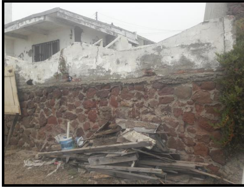
Imagen 12. Propiedad existente con deterioros notables debido al abandono 1
