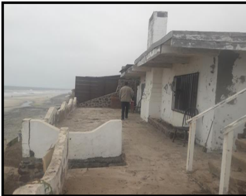
Imagen 13. Propiedad existente con deterioros notables debido al abandono 2
