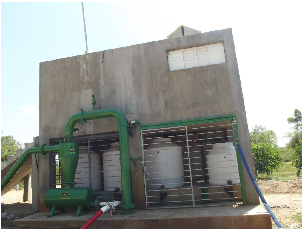
Foto 15.- Cuarto de bombas e infraestructura de bombeo y dosificación de fertilizantes.
