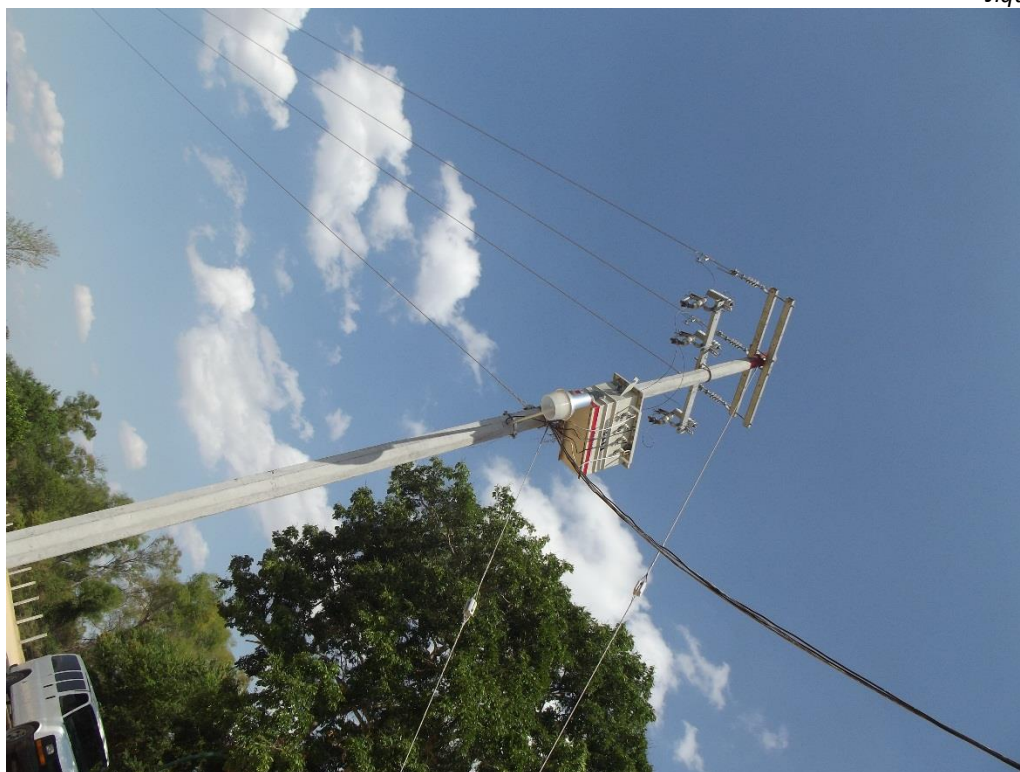
Foto 16.- Poste con acometida eléctrica para alimentación de bombas ubicado cerca de estas.
