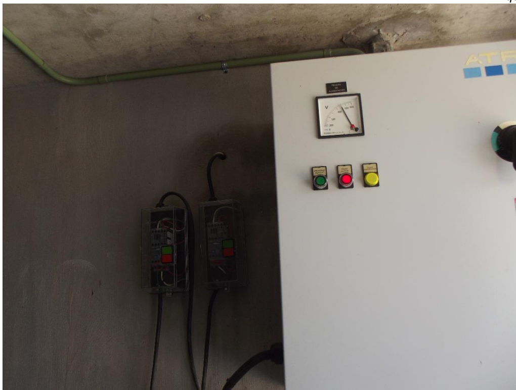
Foto 18.- Tablero de control del sistema de encendido y apagado automático operativo de bombas.
