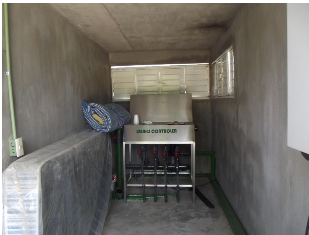
Foto 17.- Máquina dosificadora de fertilizantes, ubicada arriba del cuarto de bombas.
