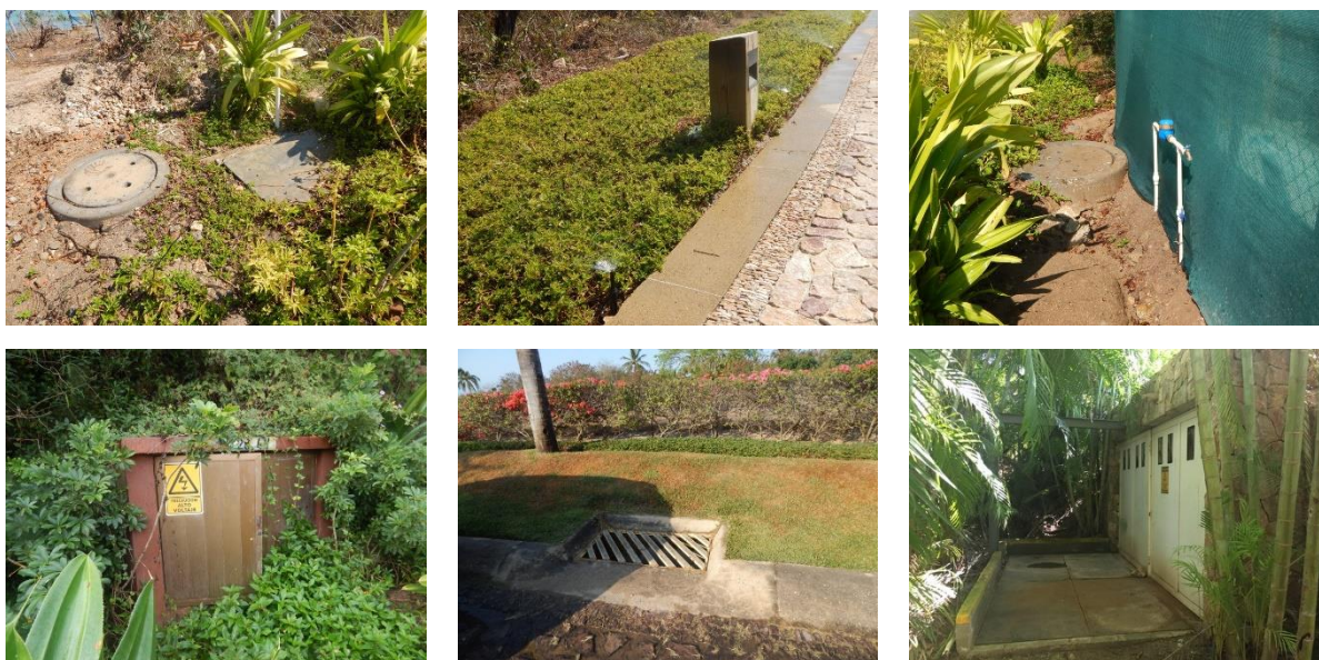
Figura 16. Infraestructura ubicada al pie del lote para el suministro de los servicios al proyecto
