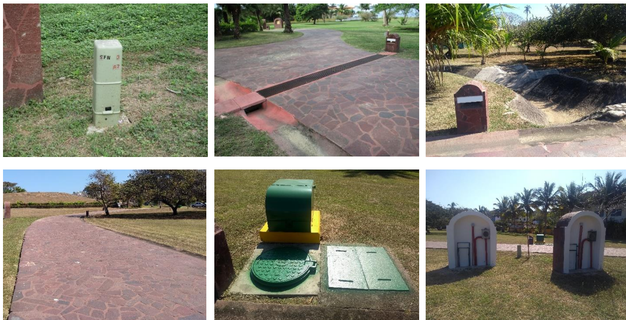
Figura 14. Infraestructura localizada en el Condominio "Las Olas" para el suministro de los servicios básicos al proyecto.
