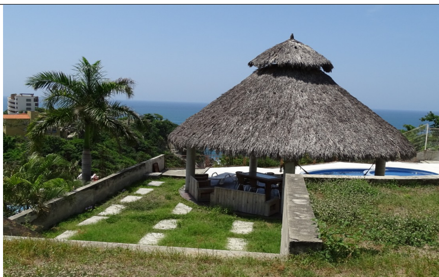
Fotografía de la palapa constituida a base de palma, misma que se encuentra deteriorada.
