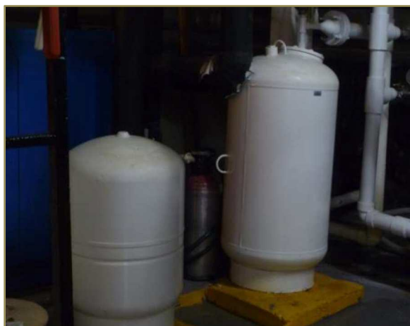
Tanque de expansión del sistema de agua caliente
