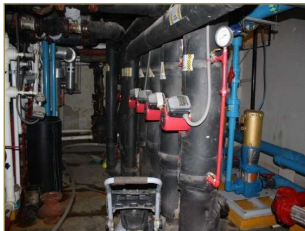
Sistema de recirculación de agua caliente
