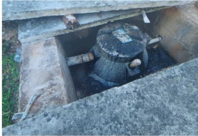
Figura 7. Biodigestor en operación en el sitio.
