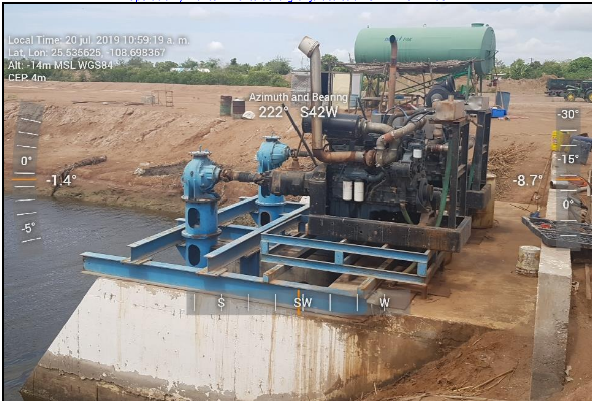
Cárcamo de bombeo, al fondo tanque de combustible.
