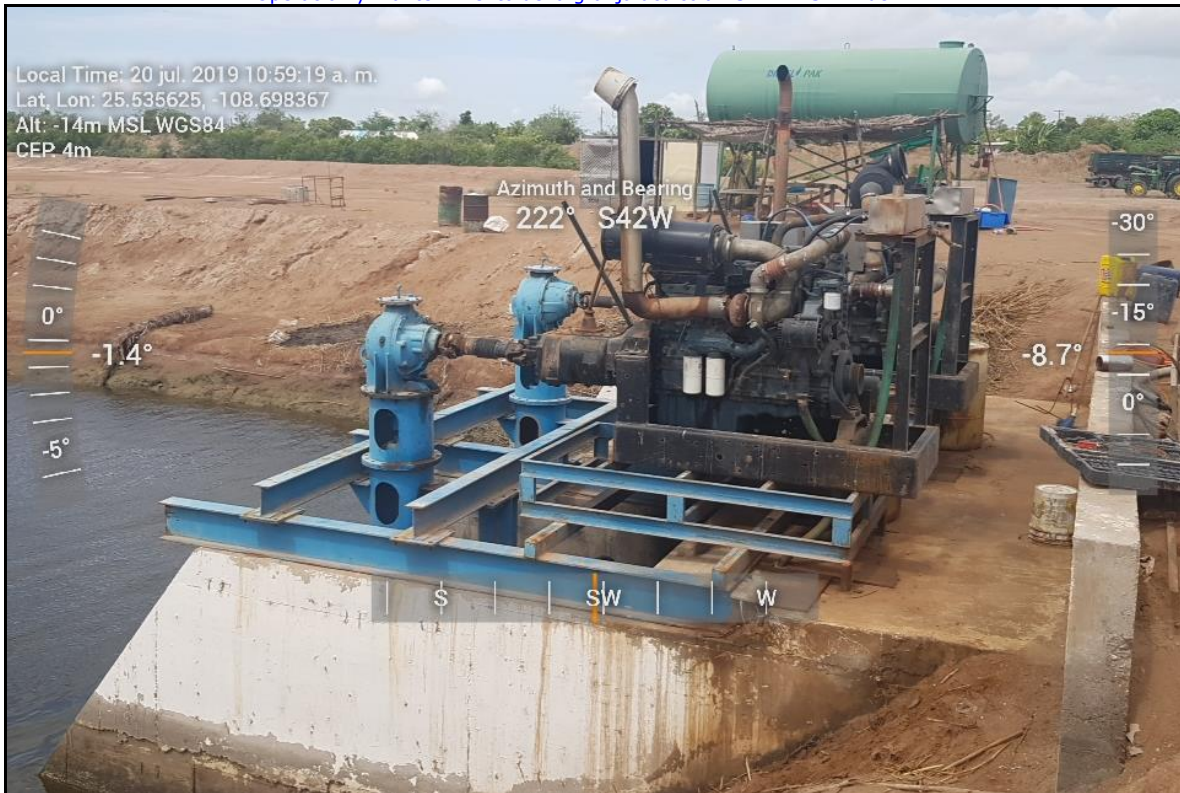
Motores del cárcamo de bombeo.
