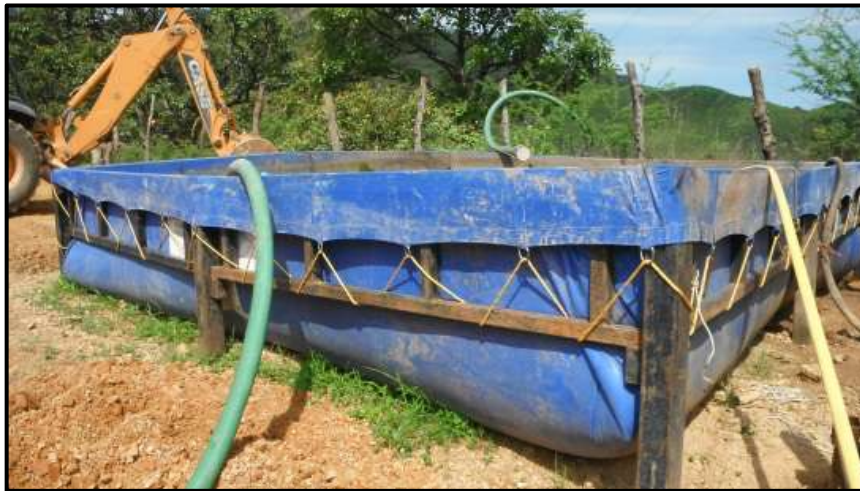
Figura II. 8 Cárcamo de lodos y agua fresca
