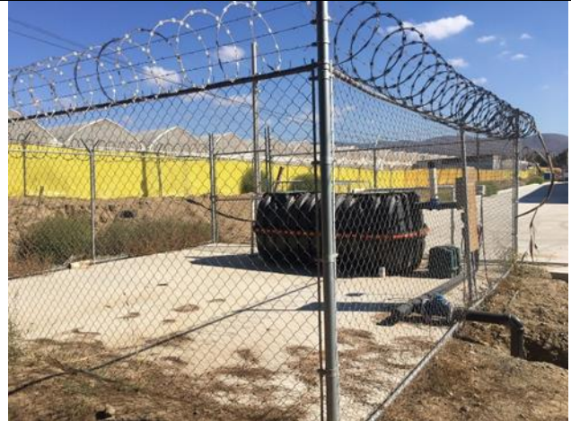
Ilustración 22 Vista de la PTAR 2, lado Sur
