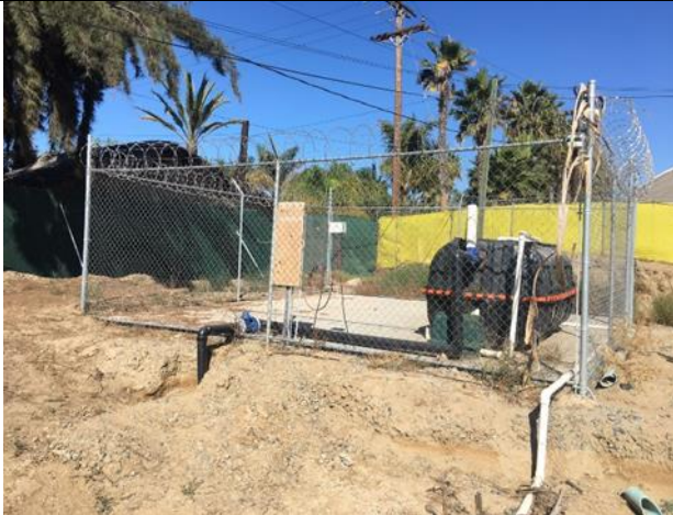
Ilustración 21 Vista de la PTAR 2, lado Sur
