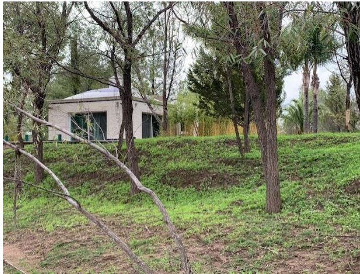
Fig. 7. Construcción en riesgo de que colapse por el deslave del terreno
