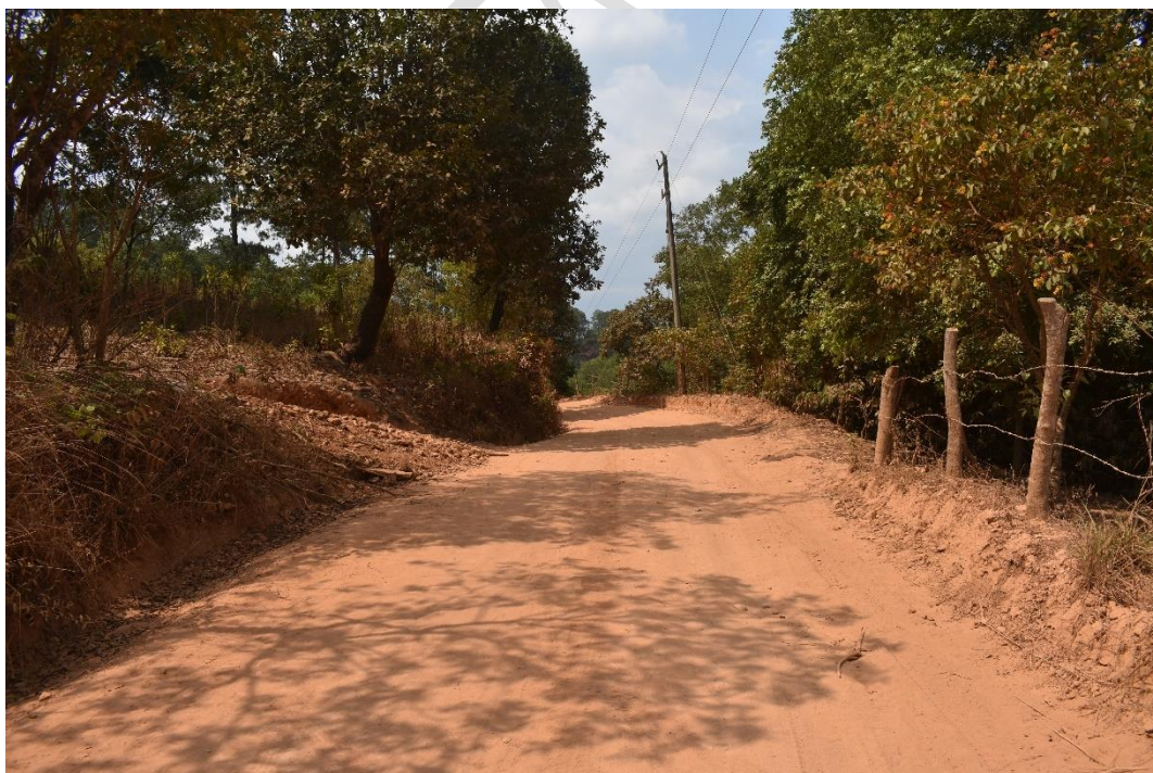
Fotografía 2. Vista del cadenamiento denominado 0+500, nótese el camino de terracería en que dirige a la localidad en malas condiciones.
