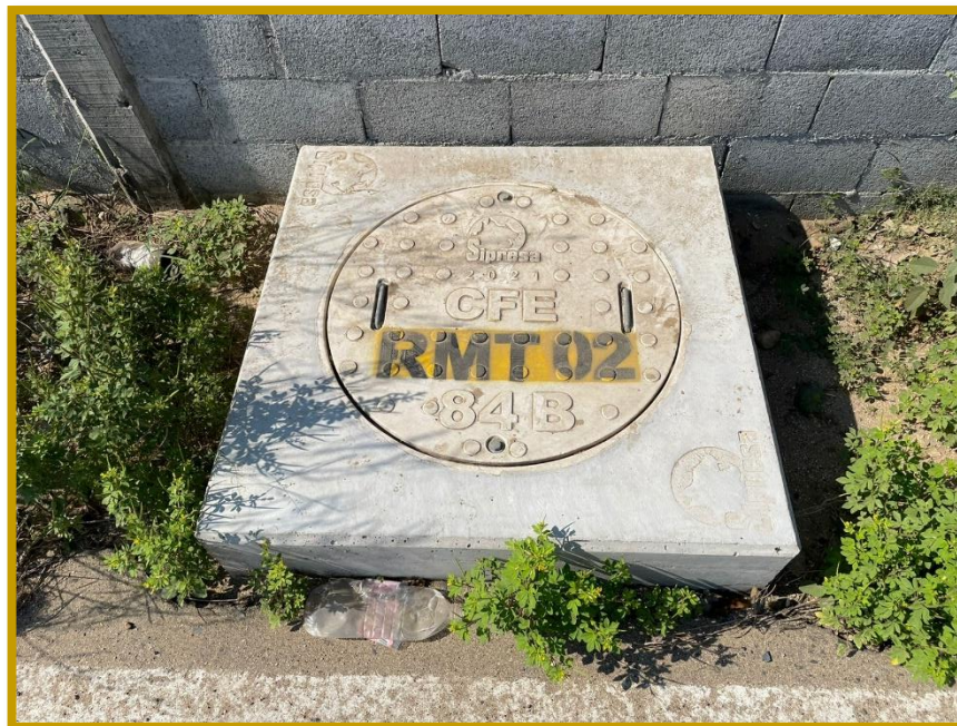
Ilustración VIII.3.3. Servicios de electrificación de la CFE del Lote 36.
