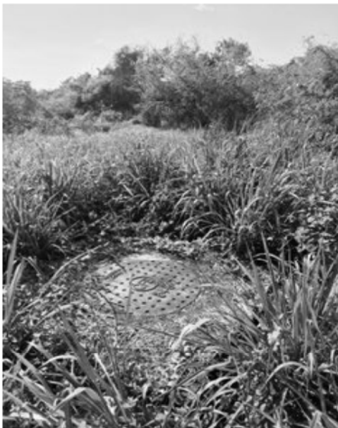
Fig.IV.38 Se observa infraestructura hidráulica instalada por el promovente anterior
