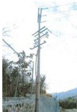
Figura II.6. Transición subterránea en sitio de Proyecto (Datos Transición subterránea, Poste de concreto 13-600, Núm. Serie: 3k-9974, Mca Herrozinc, Año fabricación 2013).
