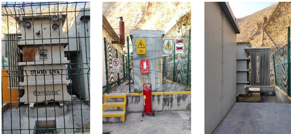
Figura II.9. Área de Transformador Eléctrico operativo.
