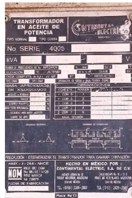
Figura II.5. Placa de identificación del Transformador Eléctrico (indica Marca Continental Electric; Capacidad 2000 kva; Núm. Serie: 4005-30677; Voltaje: 13200-480 volts).
