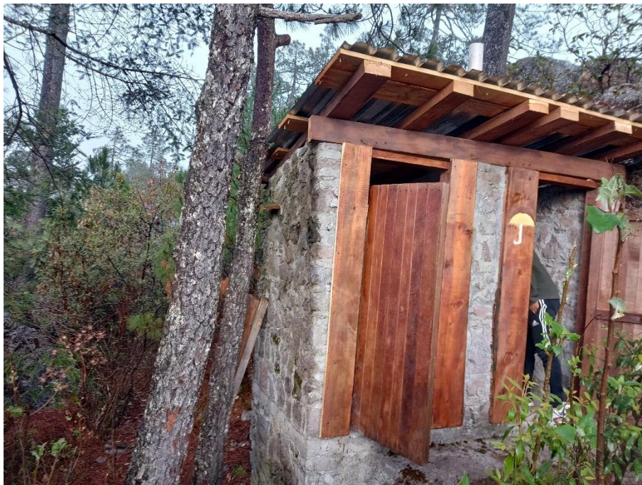
Imagen 27. No se realizó derribo de vegetación para la construcción de los baños.
