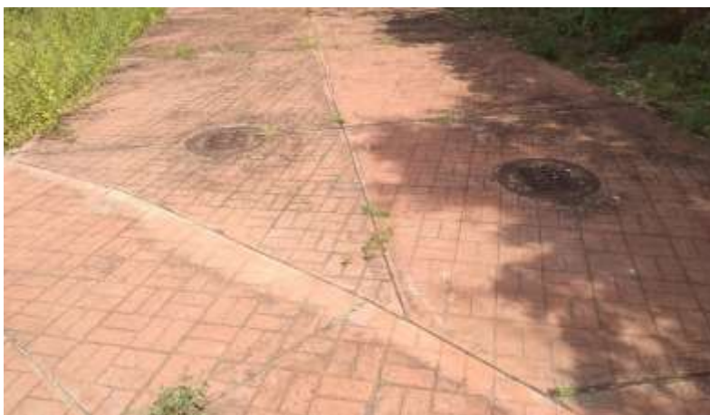
Pozos de visita de las redes de drenaje pluvial y sanitario
