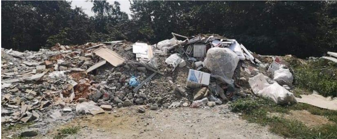
Problemas de escombro dentro del área del proyecto
