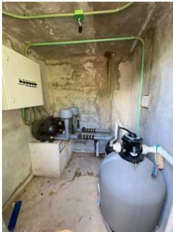
Figura 13. Mecanismo de la Planta de tratamiento.
