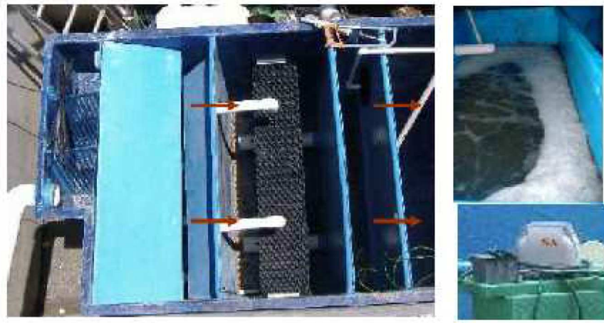
Figura II.7. Parte del tanque con sistema piraña.
