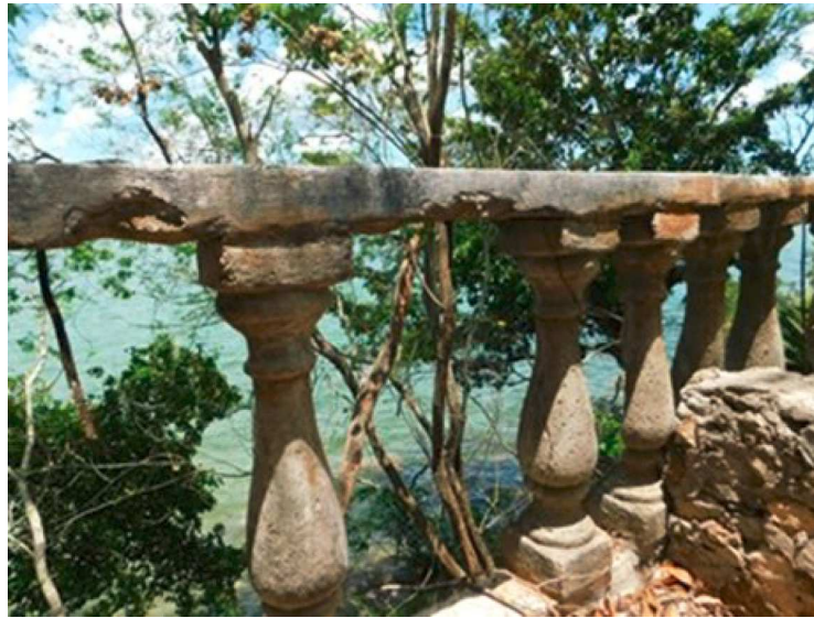
Condición de deterioro del barandal ubicado en el límite del predio con la zona federal.
