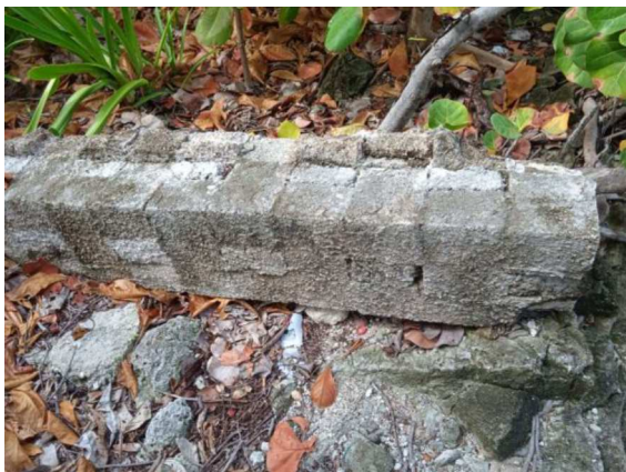
Figura 3. Estructura de concreto y block en abandono y en ruinas.
