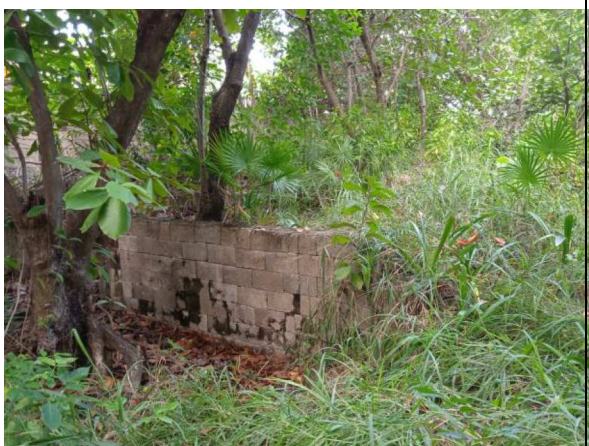
Figura 5. Pequeño muro de block en abandono y en ruinas.
