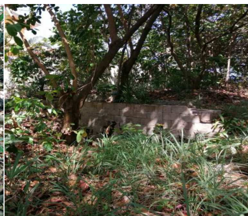
Figura 2. Pequeño muro de block en abandono y en ruinas.
