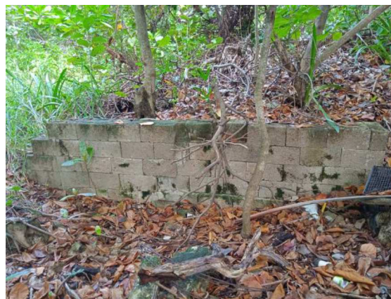
Figura 4. Pequeño muro de block en abandono y en ruinas.
