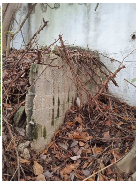
Figura 6. Pequeño muro de block en abandono y en ruinas.
