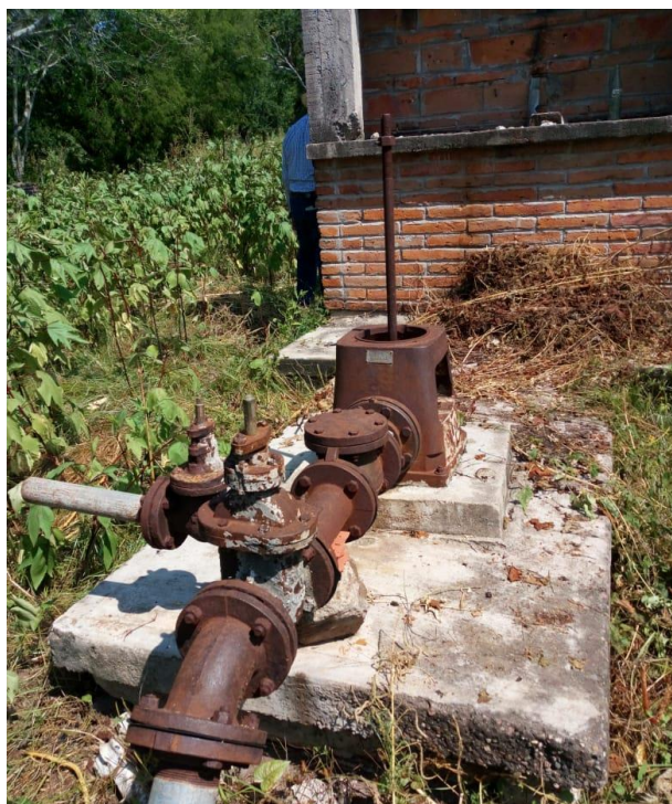
Ilustración 6 Obra subterránea en desuso, ya que no cuenta ni con equipo de bombeo
