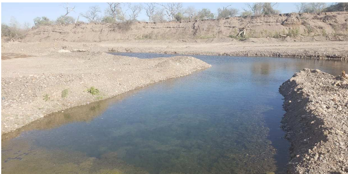
Fotografía No. 6. Taludes erosionados por las avenidas en épocas de lluvia.
