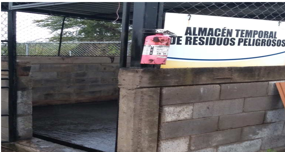
Imagen 19. Almacén temporal de residuos peligrosos.
