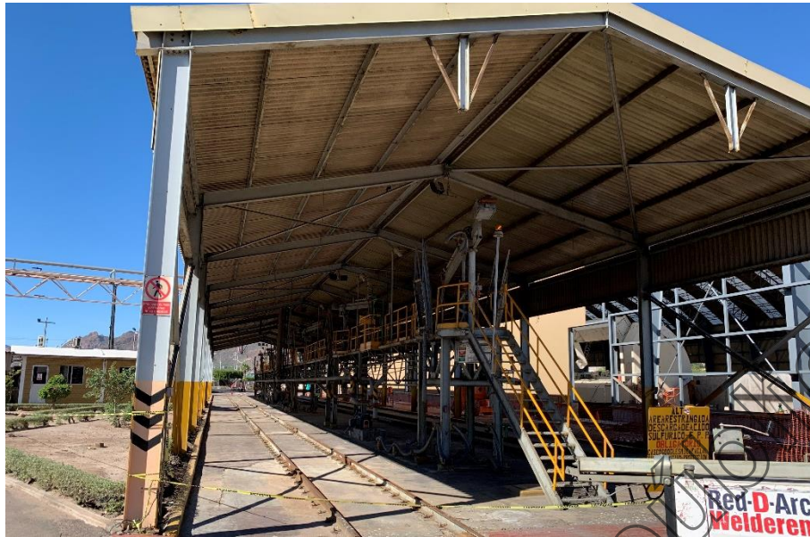
Figura II.5.- Plataforma para la descarga de ácido sulfúrico.
