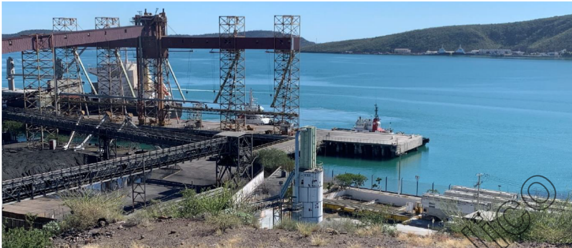
Figura II.10.- Área de embarque de H_2SO_4 a buques tanque. Del lado izquierdo el rack que sostiene la tubería proveniente de los tanques T-8, T-9, T-10, y T-11. El tanque cilíndrico vertical al centro es el T-19.
