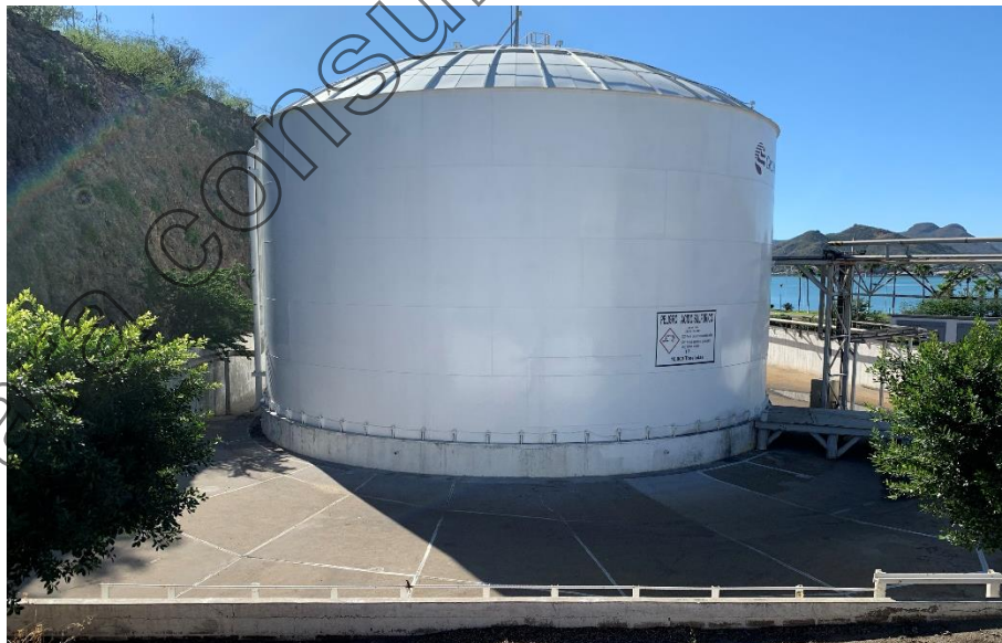
Figura II.8.- Tanque de transferencia T-7, localizado en el interior de un dique de contención de derrames.
