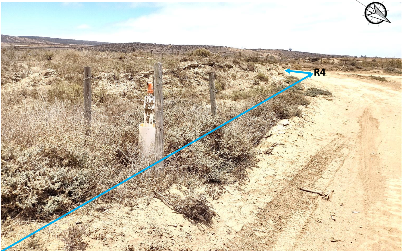
Foto 14. Vista de una sección de la línea de tubería del agua de rechazo al llegar al vértice R4, se observa una válvula de desfogue de aire.
