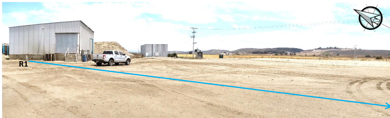
Foto 10. Vista del inicio de la tubería de conducción de agua de rechazo a partir de la planta desaladora (R1).
