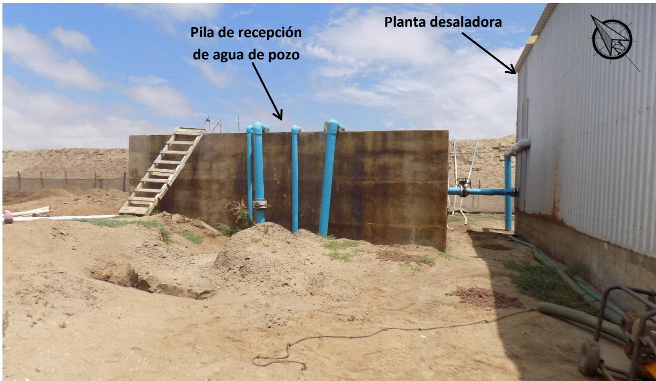
Foto 3. Pila de recepción de agua de pozos para la alimentación de la planta desaladora.
