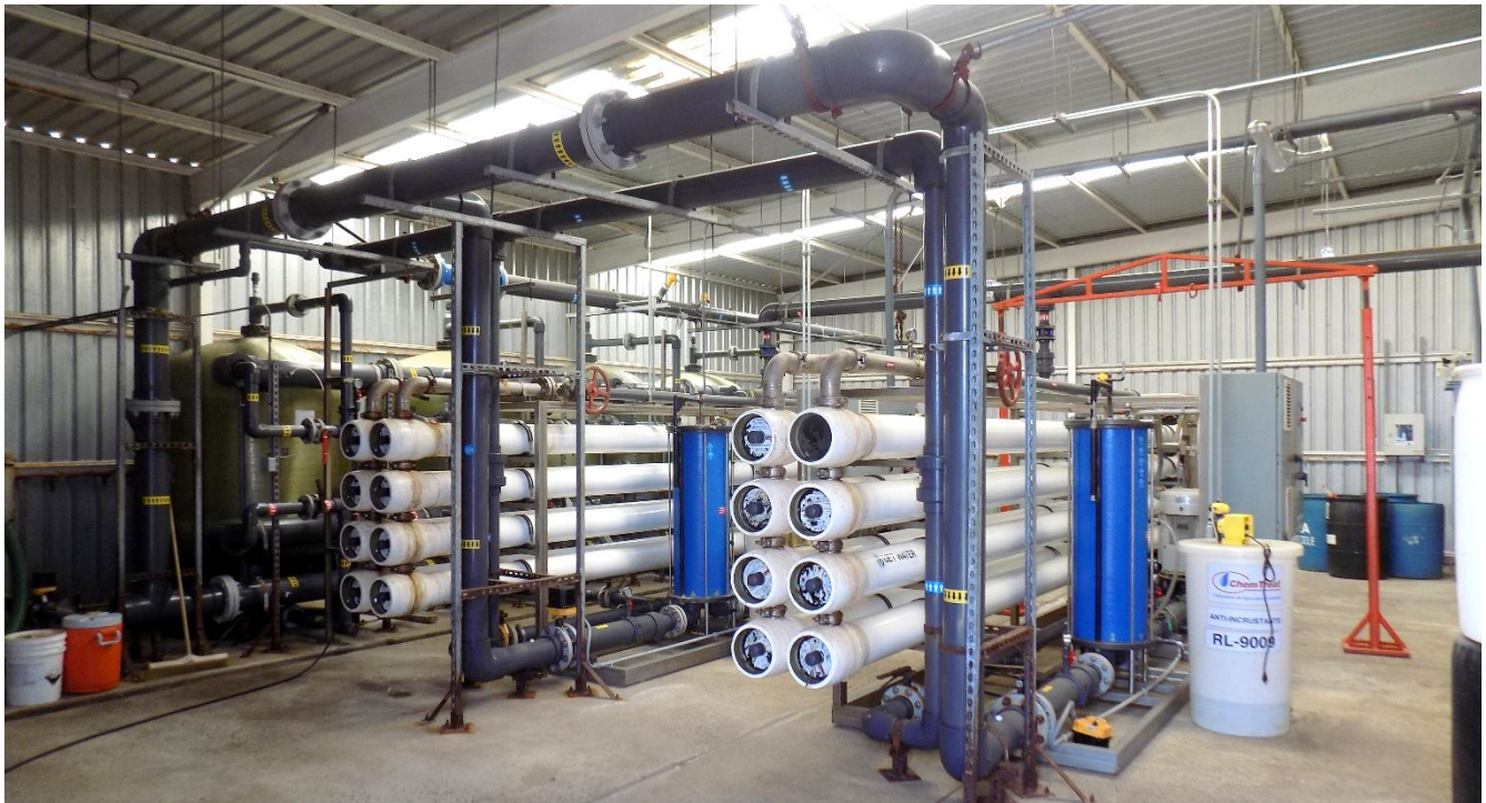
Foto 2. Par de módulos de osmosis inversa instalados en el interior de la nave.
